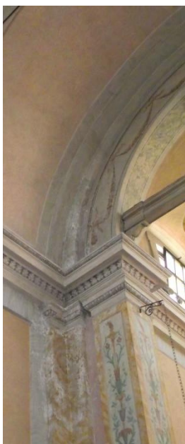
Angolo sinistro danneggiato
